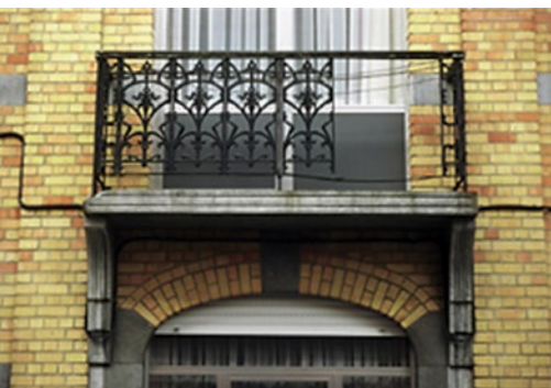
Balkon met gietijzeren borstwering waarvan twee elementen gebroken zijn.
