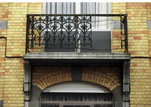
Balcon à garde-corps en fonte dont deux éléments ont été brisés.
