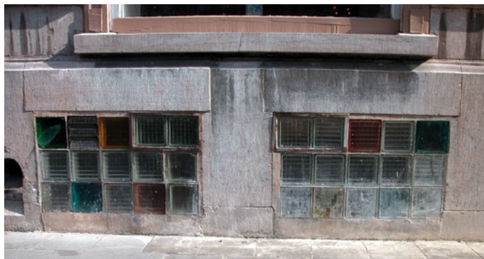
Fenêtre de cave bouchée par des briques de verre.
